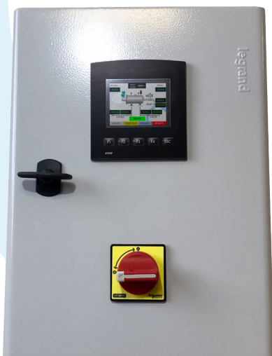
Coffret de commande
